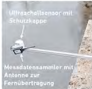
Abb. 1: Bild einer Messeinrichtung zur berührungslosen Wasserstandsmessung
